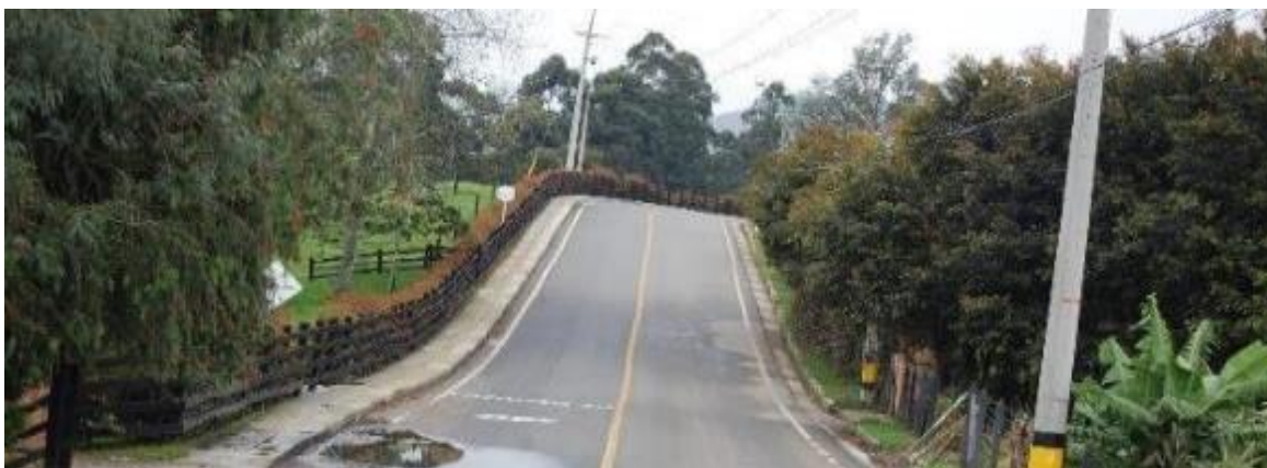
Figura 111. Estado actual vía Colegio Cabeceras – Pontezuela – La Ceja. 2016
