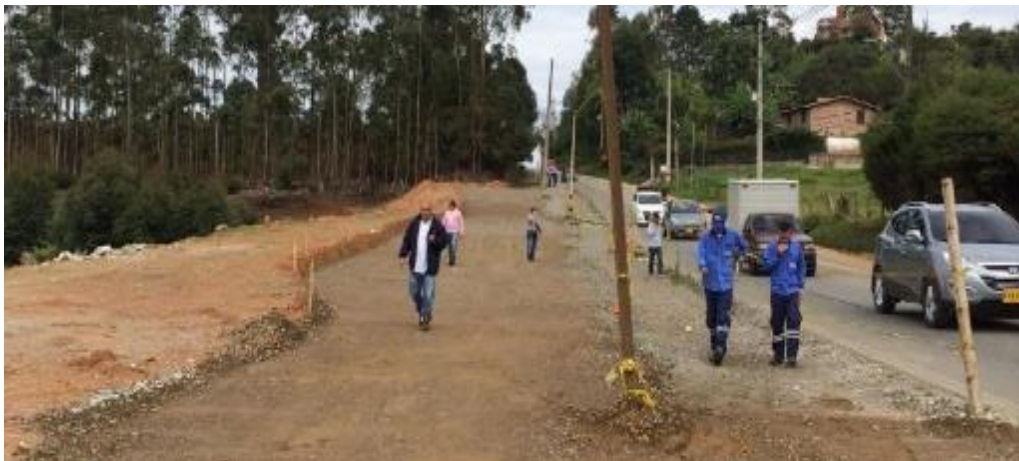
Figura 52. Estado Actual tramo Lotus 2016.
