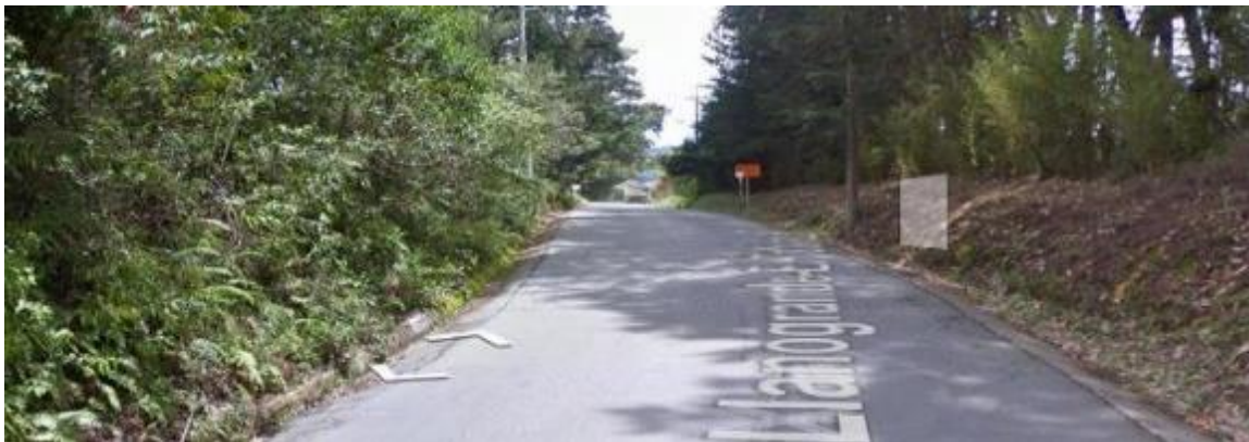
Figura 114. Estado actual vía La Pica – Cruce El Tablazo 2015.
